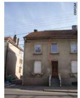
(photo 69) Fissuration fine sur mur extérieur
