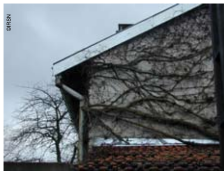
(photo 37) - Frémifontaine (départ. 88) Fissure extérieure sur bâtiment
