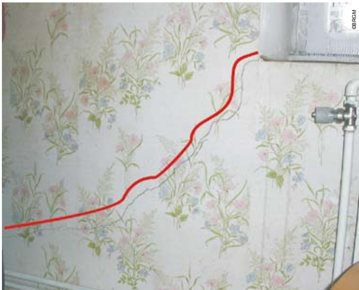
(photo 35) - Jeanménil Lieu-dit Larifontaine fissuration intérieure et extérieure
