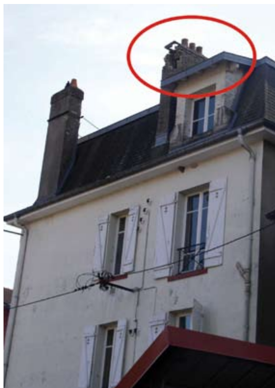
(photo 74) Désordre sur cheminée.
