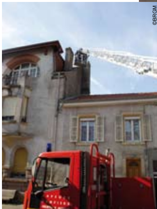
(photo 70) Intervention des pompiers sur une cheminée menaçante
