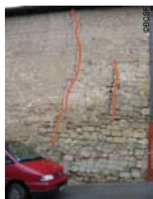
(photo 59) - Fissuration sur ancienne ouverture
