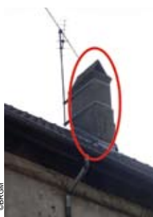
(photo 62) Désordre de cheminée
