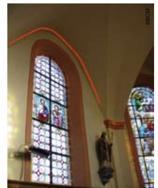
(photo 32) Destord Fissuration au raccordement des tympans avec la voûte
