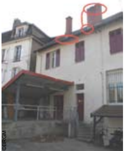
(photo 67) Baccarat (Dép.54) Endommagement de cheminées
