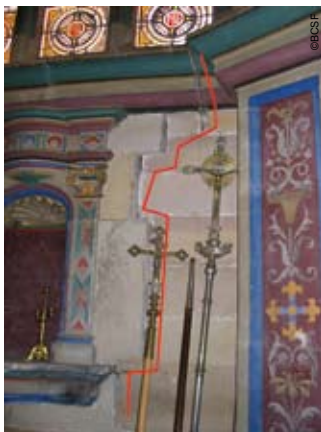
(photo 51) - Large agrandissement d'une fissure derrière l'autel.
