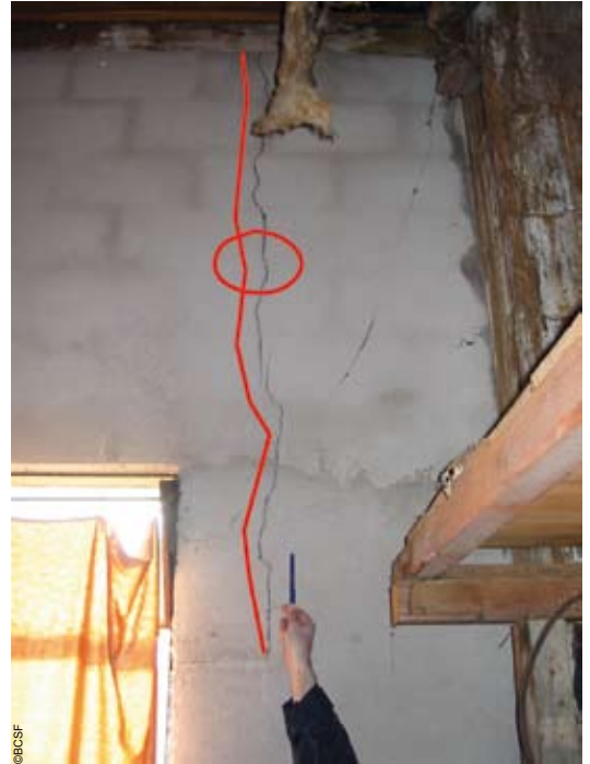
(photo 45) - Rambervillers (départ. 88) - Fissuration large de part en part d'un mur porteur en agglo.
