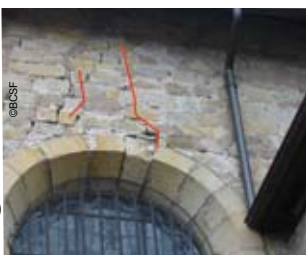
(photo 58) - Agrandissement de fissures existantes
