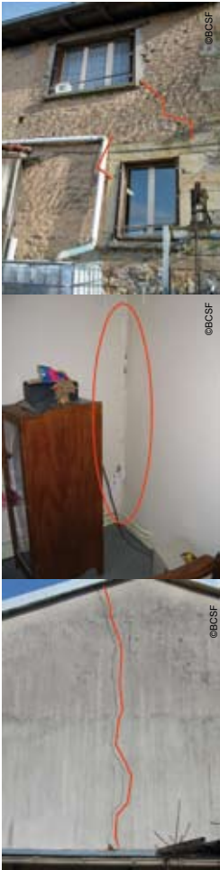
(photo 33) Jeanménil Lieu-dit Larifontaine - fissuration généralisée sur bâtiment de vulnérabilité A.
