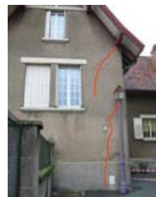
(photo 65) Fissures d'angle sur une maison proche de l'église
