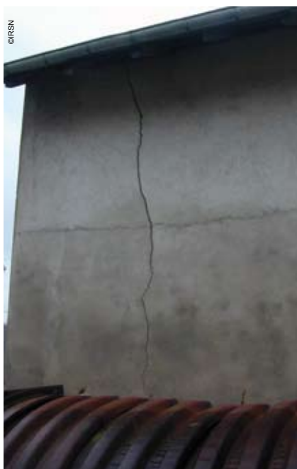
(photo 39) - Frémifontaine (départ. 88) Fissure extérieure sur bâtiment
