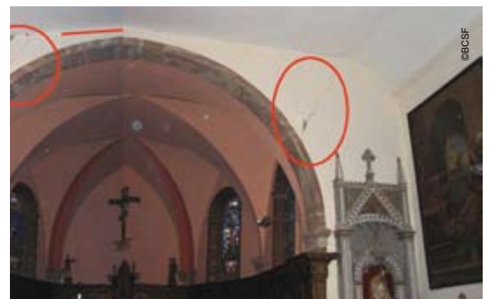
(photo 22) Sainte-Hélène Fissuration au niveau du toit de la nef et de l'arc principal.
