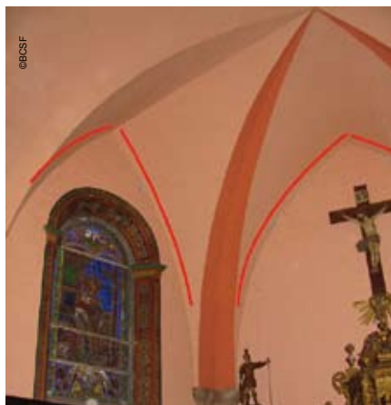
(photo 21) Sainte-Hélène Fissuration généralisée au raccordement des tympans et des structures contreventées.
