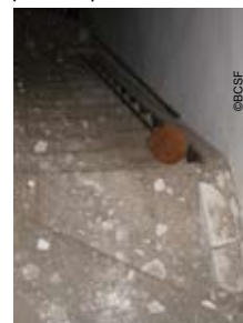
(photo 23) Sainte-Hélène (départ.88) Chute de petits morceaux de plâtre à proximité du clocher
