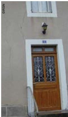
(photo 38) Frémifontaine (départ. 88) Fissure extérieure fine sur bâtiment
