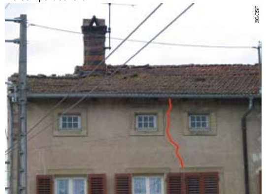
(photo 47) Rambervillers (départ. 88) - Fissuration légère sur maison particulière.
