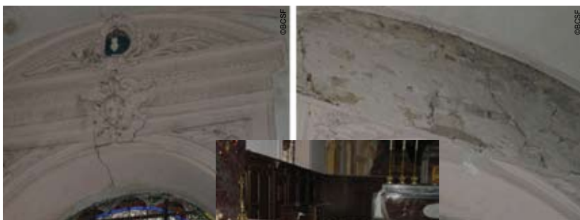
(photo 60) Chute de décor en plâtre
