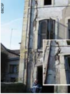
(photo 41) - Rambervillers (départ. 88) - Elargissement d'une fissuration sur bâtiment en cours de démolition.
