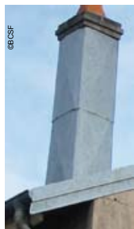
(photo 20) Exemple d'un chemisage en acier galvanisé ayant protégé de nombreux éléments de ce type sur la région.
