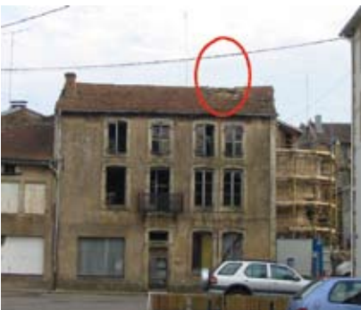
(photo 44) - Rambervillers (départ. 88) - Chute de cheminée sur bâtiment en mauvais état.
