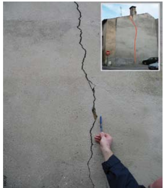
(photo 46) - Rambervillers (départ. 88) - Fissuration large, vraisemblablement due à un effet de "claquage" sur le crépis.
