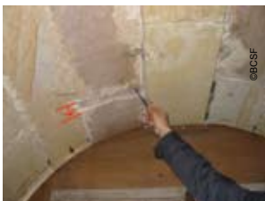
(photo 64) Affaissement d'une clef de voûte
