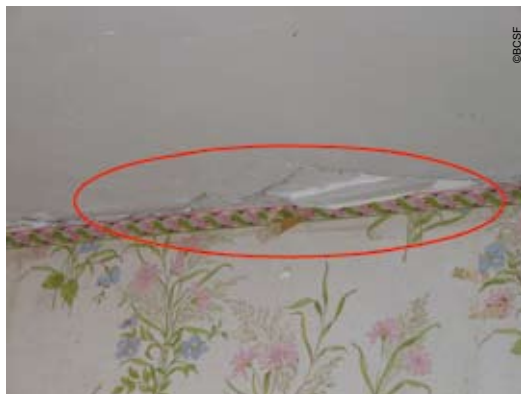
(photo 34) - Jeanménil Lieu-dit Larifontaine - fissuration entre mur et plafond
